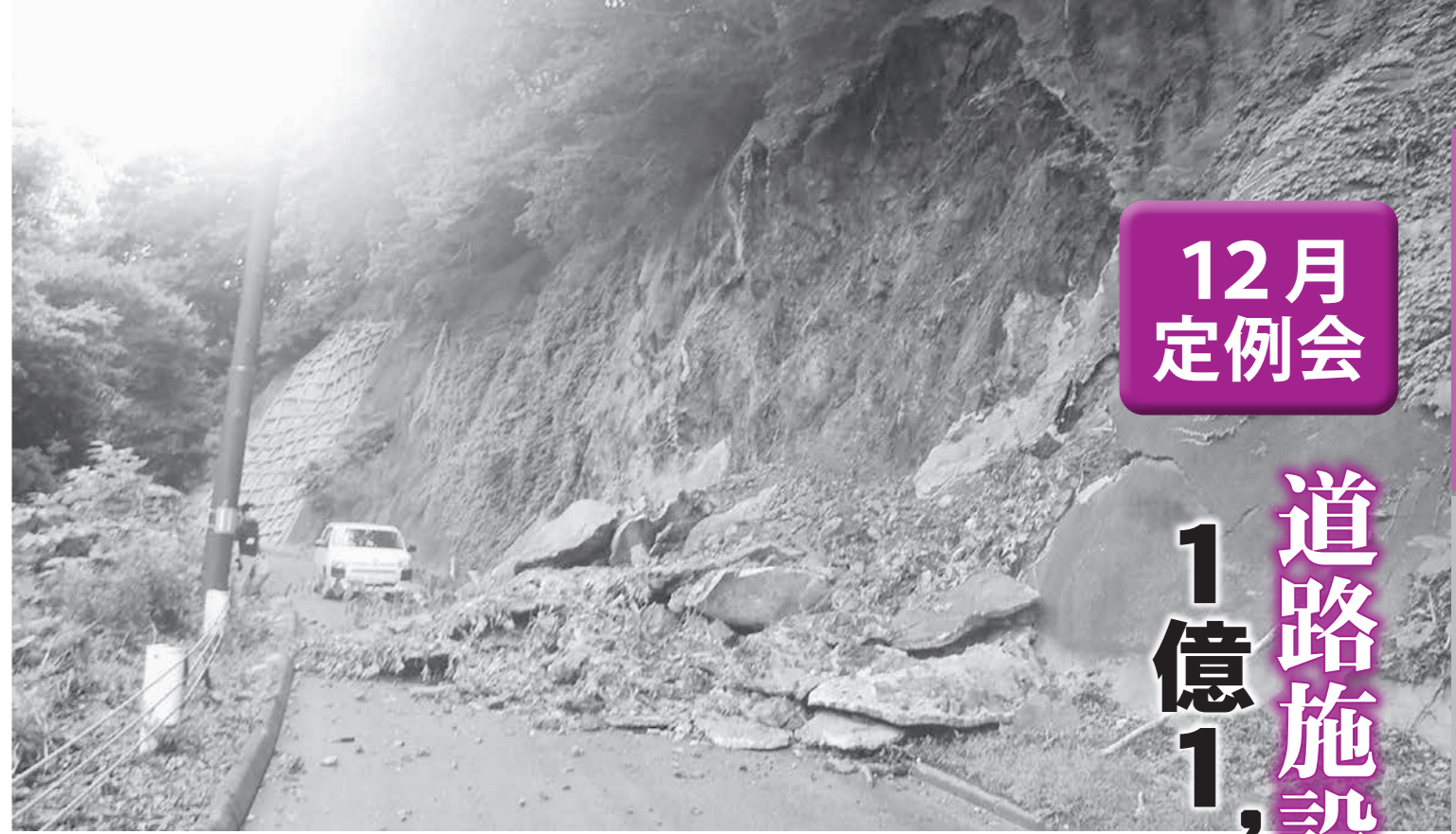
法面が崩落した村道弁天港線
