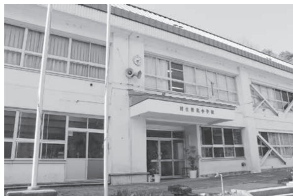
老朽化が進む小学校
