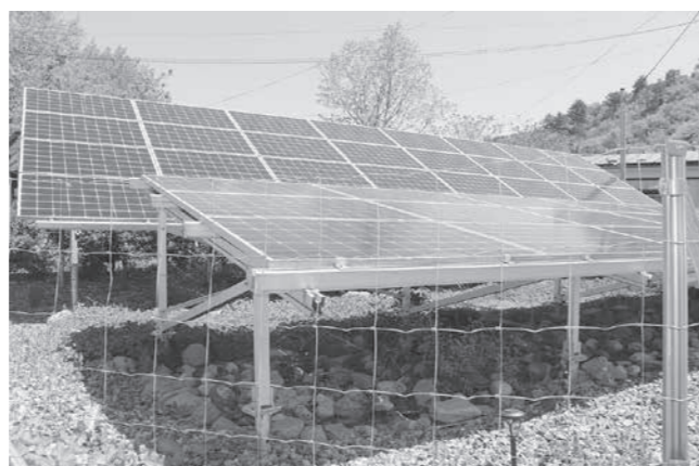
実際にソーラー発電を活用している様子
