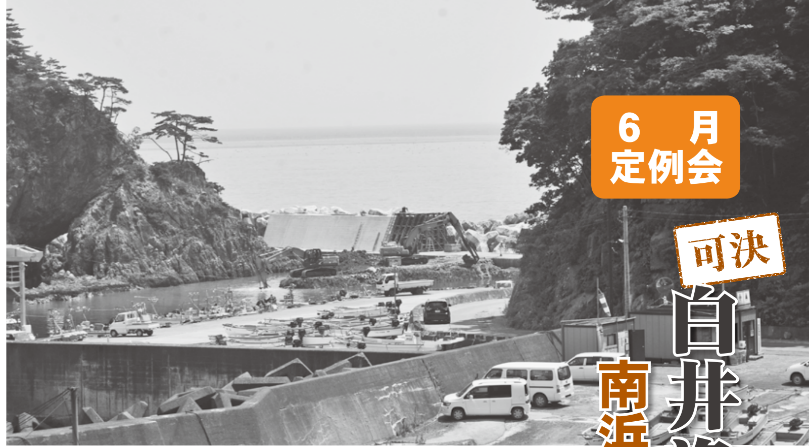
防波堤のかさ上げ工事が行われている白井漁港南側（写真中央）
